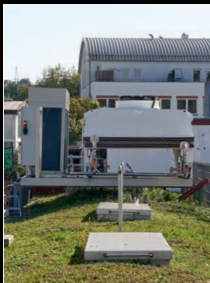
Alles kompakt im Außenbereich: Kälteerzeugung und Freikühler für die hocheffiziente Ofenkühlung.
