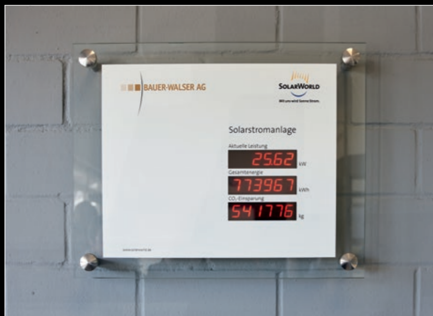
Auch im Herbst deckt die Photovoltaikanlage einen beachtlichen Teil des Energiebedarfs. Der Screen im Empfangsraum zeigt uns nur einen kleinen Teil.
