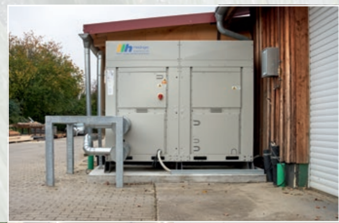
Zentrale, bivalente Luft-Wasser-Wärmepumpe im Außenbereich.
