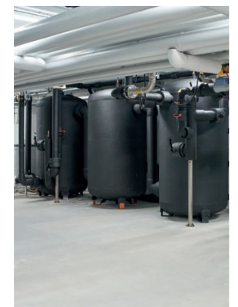
Puffertankbatterie mit in Summe 12.000 Liter Puffervolumen für Wärme und Kälte.
