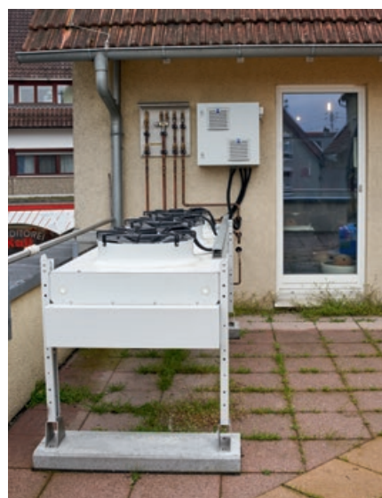
Muss draußen bleiben: Gaskühler mit 40KW Leistung.
