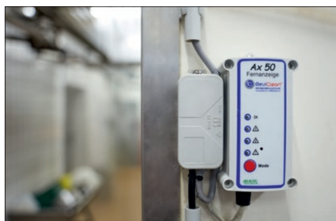
Alles gut überwacht: Alle Geschäftsbereiche wurden mit CO 2 Sensoren ausgestattet.
