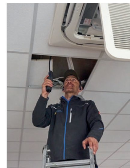
Zum Routine Check gehört auch die Dichtigkeitsprüfung der Klimaanlage.
