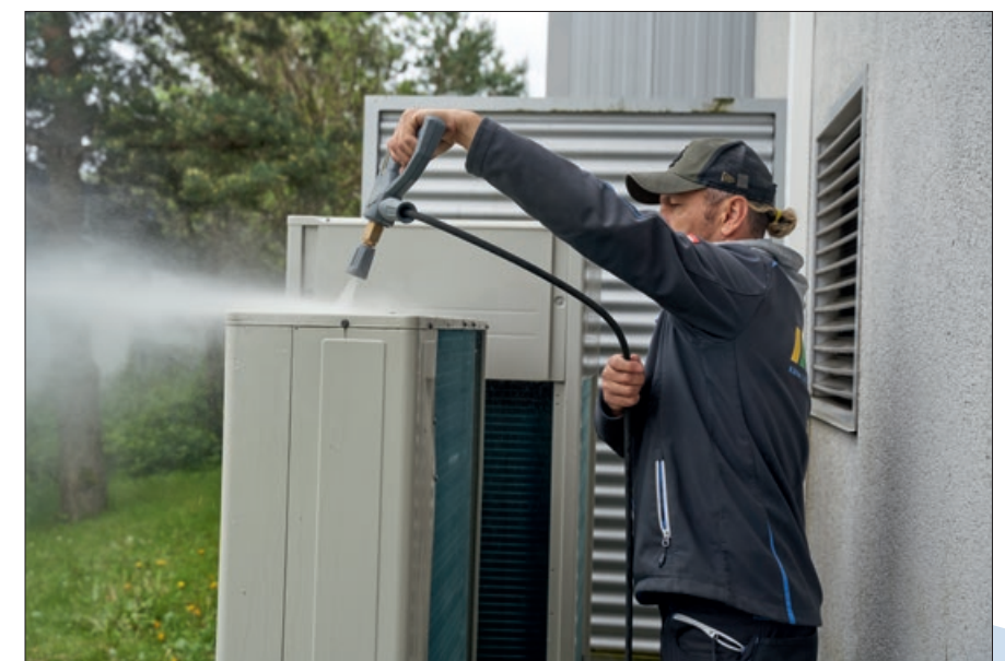
Großputz mit Volldampf: Zur Wartung gehört auch die Reinigung der Außen-einheiten.
