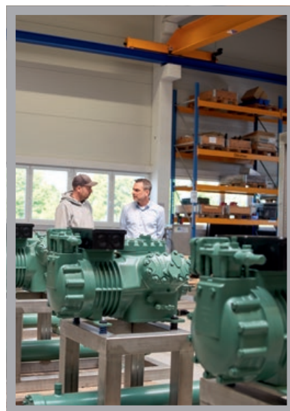
Grüne Technik mit funktionalem Charme: Die fertig montierten Verdichter/Verflüssiger-Einheiten in soliden Stahlrahmen.
